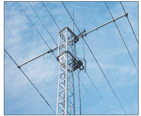
Bild 4: Einspeisung der FD5 mit 1:6-Balun Fotos: DL7PP
